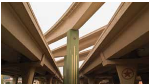
Ортотропные ребра использованы в конструкции развязки High Five в Далласе, штат Техас, США.
